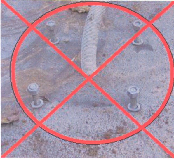
Fig 2 Incorrect Conduit Position
